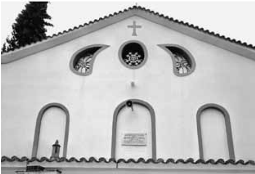
Εικ. 45Α (επάνω) & Β. Πυργετός. Ναός Αγίου Γεωργίου [1856-1857]. - Α΄: Νοτιο-δυτική άποψη. - Β΄: Πάνω μέρος δυτικής όψης. (Άγγελος Σινάνης, DSC 9151 & 9154 (απόσπασμα) της 01.04.2011).
