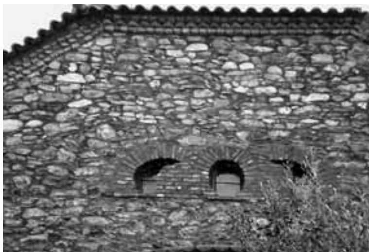
Εικ. 106Β. Ομόλιον. Άγιος Κωνσταντίνος. Οι πλινθόκτιστοι αχλαδόσχημοι φεγγίστες στον παλαιότερο τοίχο της ανατολικής πλευράς (Α.Π. SANYO 056 της 20.02.2011)
