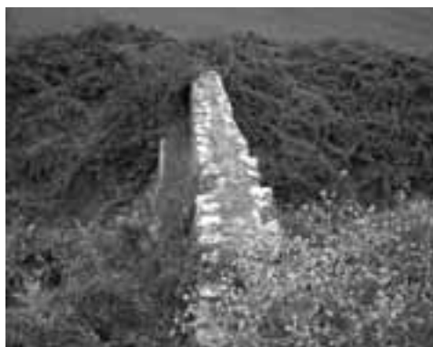
Εικόνα 6. «Καμάρα» διέλευσης αγωγού για την μεταφορά νερού στο δρόμο Περιβλέπτου-Ελευθεροχωρίου
