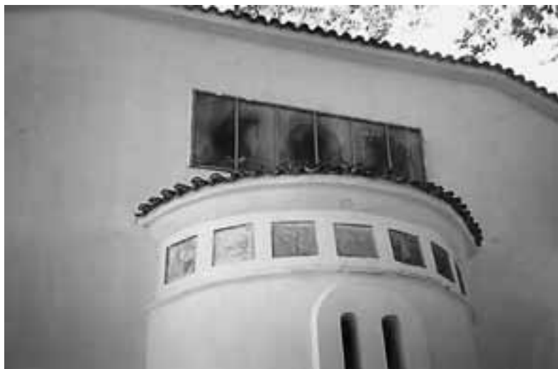
Εικ. 76Γ. Μεγαλόβρουσο (πριν Νεβόλιανη) Αγιάς. Άγιος Αθανάσιος, 1877. Τμήμα ανατολικής όψης. (Α.Π. Παρασκευή 03.09.1993).
