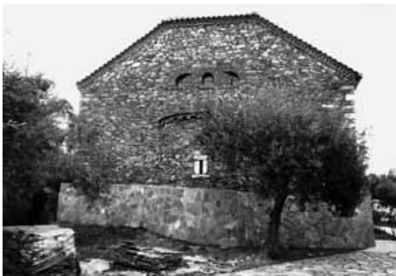
Εικ. 106Α. Ομόλιον. Άγιος Κωνσταντίνος. Ανατολική πλευρά. Διακρίνεται η διαφοροποίηση του παλαιού κάτω κτισίματος με τους αχλαδόσχημους φεγγίτες, από το επικαθήμερο νεώτερο λευκάζον φως (Πρβλ. και εικ. 106Β) (Α.Π. SANYO 055 της 20.02.2011).
