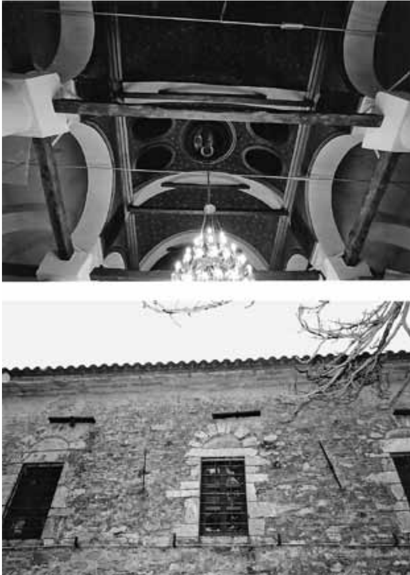
Εικ. 88Γ & Δ. Κρασιά Ραψάνης. Ναός Ταξιάρχη Μιχαήλ 1887. -Γ πάνω: εσωτερικό, θόλος κεντρικού κλίτους, τοξοστοιχίες, ξύλινοι & σιδερένιοι ελκυστήρες. -Δ: τμήμα νοτίου τοίχου με αγκυρώσεις ελκυστήρων (Άγγελος Σινάνης: DSC αντίστοιχα 9181 & 9182 της 01.04.2011).
